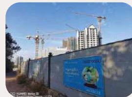
工地降塵噴淋設施
