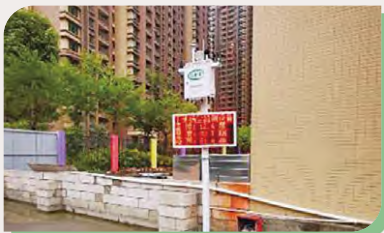
揚塵監測設備
