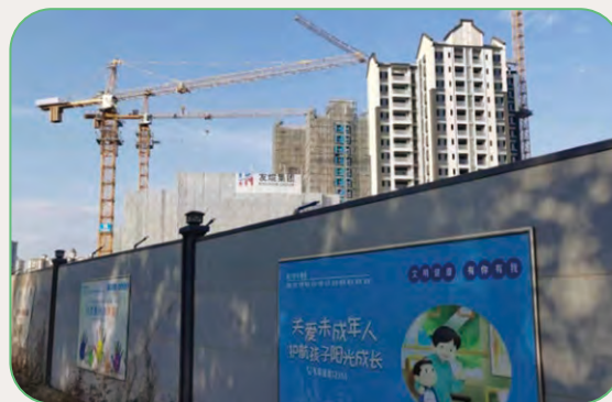
工地降塵噴淋設施
